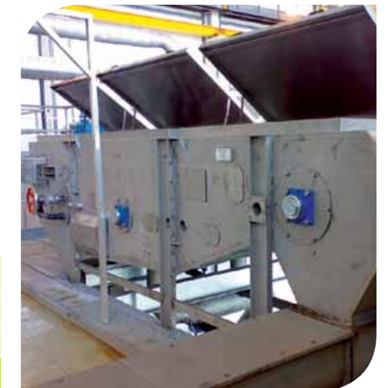
Bandeindicker (Trinkwasseraufbereitungsanlage Pest-Nord)
